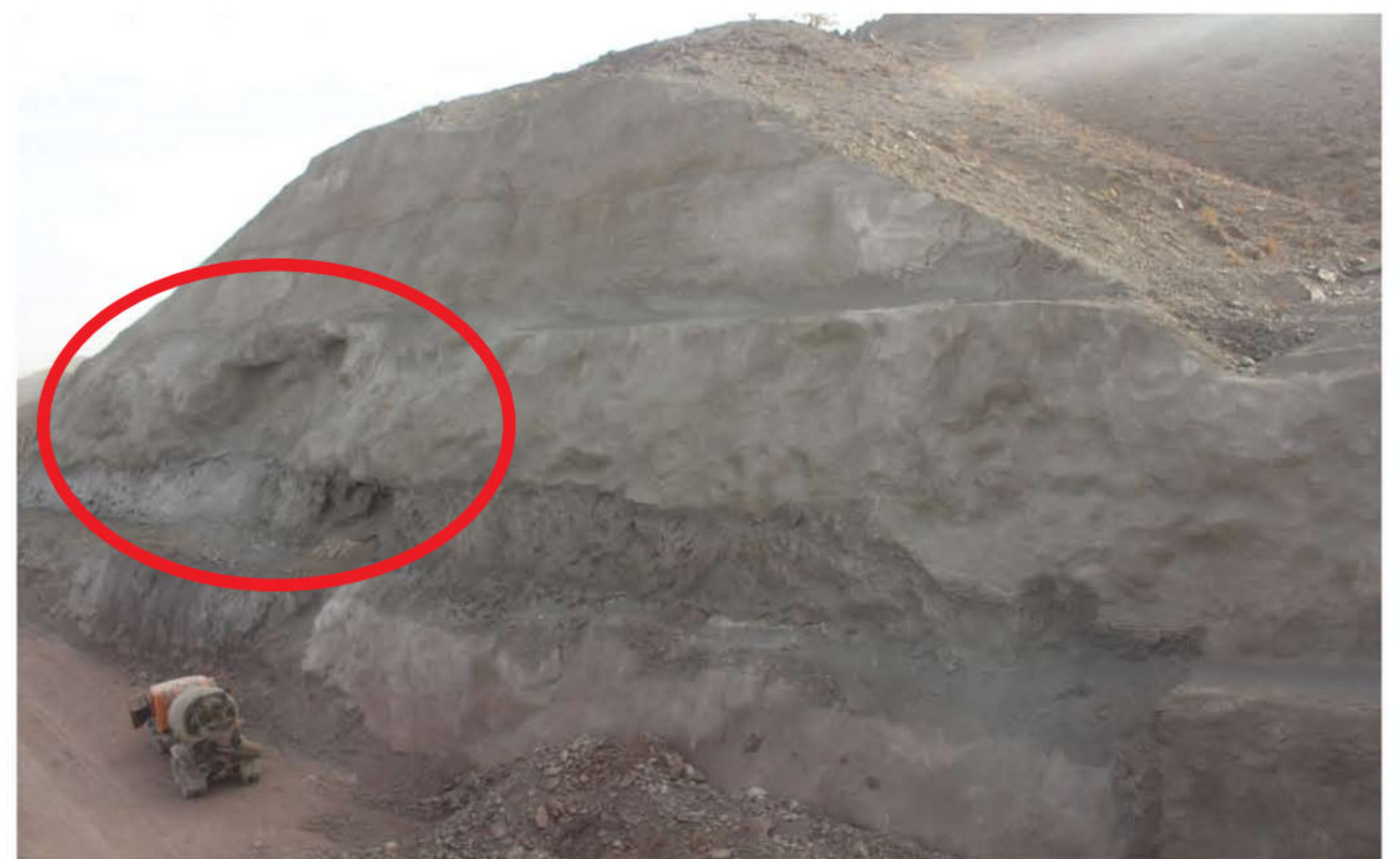
شکل ۱: عدم اجرای صحیح ترانشه
